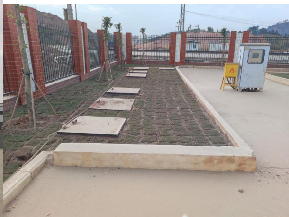
一体化污水处理设施
