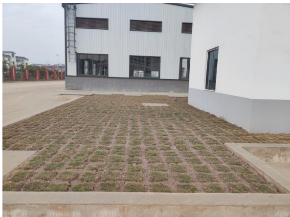
事故应急池（初期雨水收集池）
